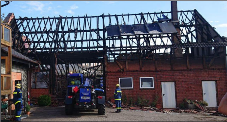
Aufräumarbeiten zusammen mit dem THW beim Scheunenbrand bei Weiders
